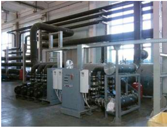
Насосне відділення холодильної установки ПрАТ "Завод напівпровідників"
