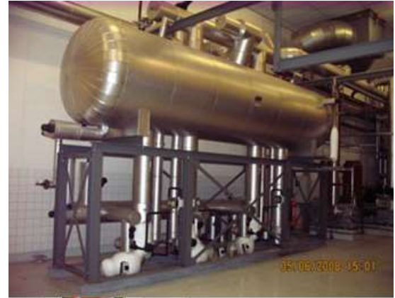
Вуглекислотна насосно-циркуляційна система
