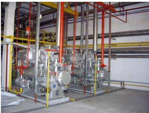
Аміачний компресорний цех ТОВ "Данон-Дніпро"
